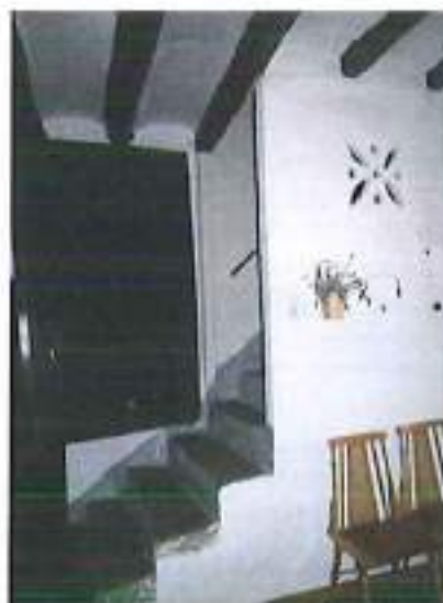
Interior, escala amb sistema de tancament de porta automàtic i icona igual que l'ermita
