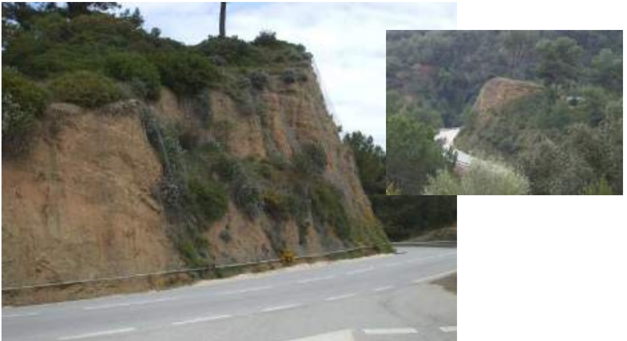
Fotografia 13: Talussos a la carretera B-120, en el límit est de l'àrea d'estudi.
